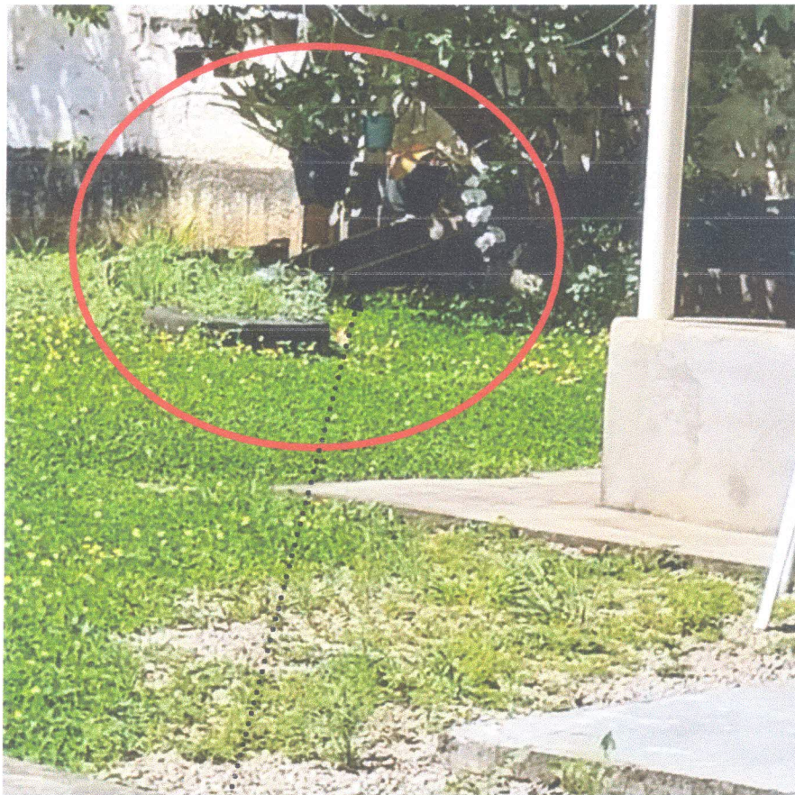
Foto 06- Vista da saída irregular de águas pluviais no terreno dos requerentes
