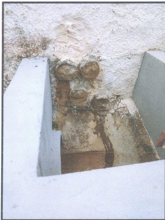
Foto 07- Vista da caixa de captação dentro do imóvel da empresa Cia. Das Etiquetas e as saídas das tubulações de águas pluviais bloqueadas, provenientes do imóvel onde funciona a empresa Hábil Serviços.
