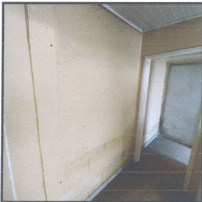
Foto 13 – Umidade na parede de divisa e ao longo do piso
