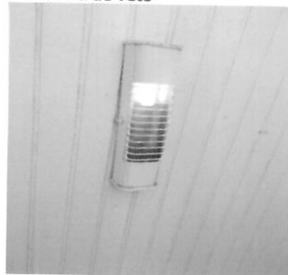
Luminária de Teto
