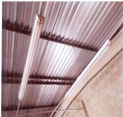
Luminária de Teto
