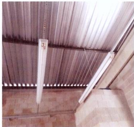
Luminária de Teto
