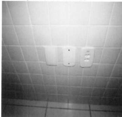
Interruptores e tomadas
