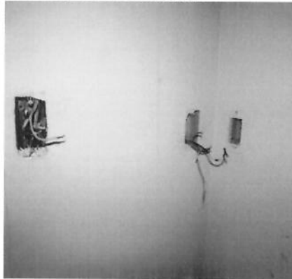
Interruptores e tomadas
