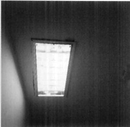
Luminária de Teto
