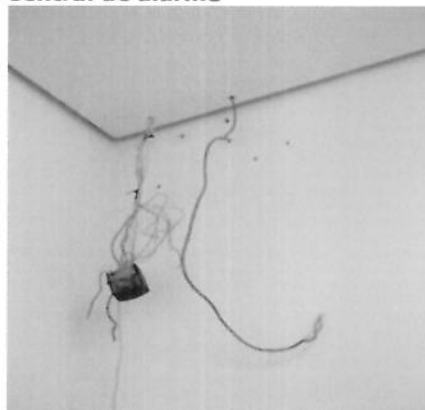
Central de alarme
