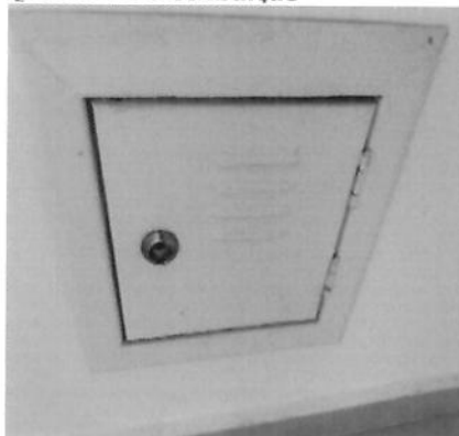
Quadro de distribuição
