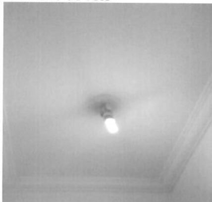
Luminária de Teto
