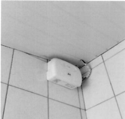
Central de cerca elétrica
