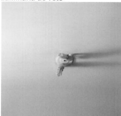
Luminária de Teto
