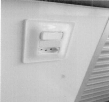
Interruptores e tomadas
