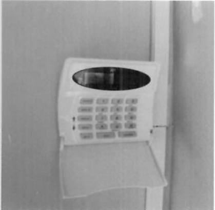
Sistema de Alarme
