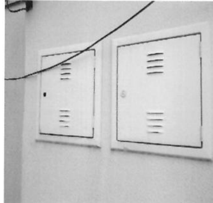
Quadro de distribuição
