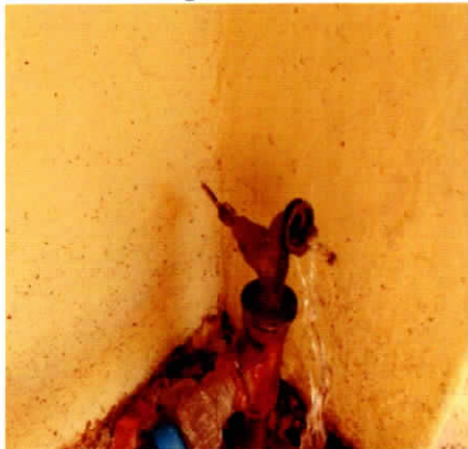
Cavalete de Água
