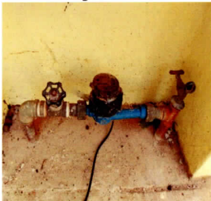
Cavalete de Água
